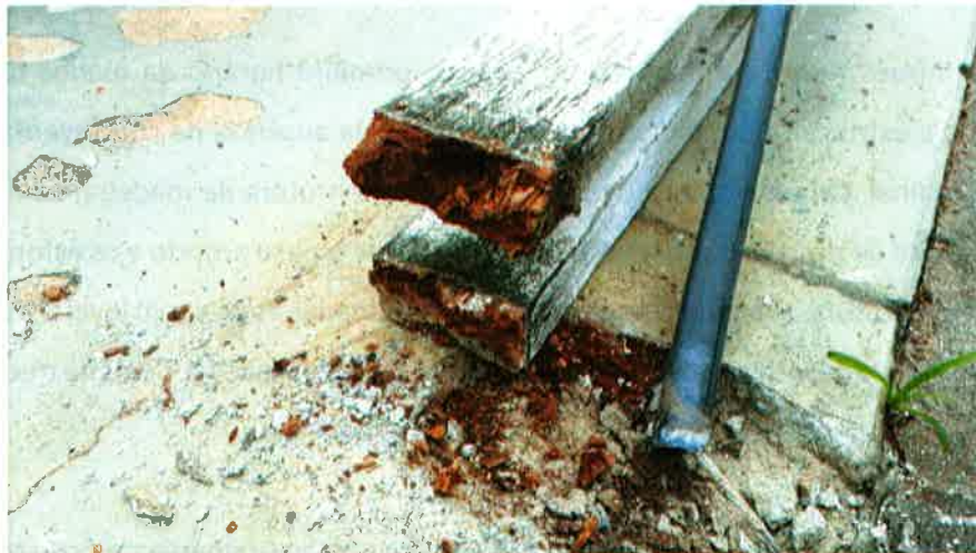
Imagem 2 – Estado da madeira no ponto de rompimento da estrutura de apoio.
