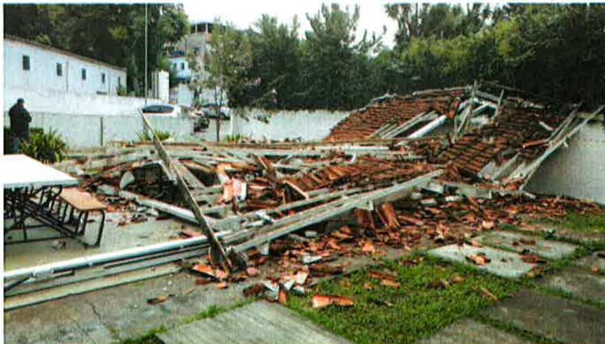
Imagem 1 – Estrutura tal como estava pela manhã do dia 30/11/2017.
