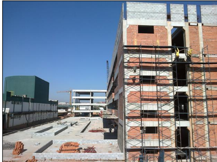
Figura 12 - Obra no campus definitivo de Guarulhos (Pimentas) em Junho de 2014 (Vista Lateral). Fonte: http://www2.unifesp.br/humanas/home/index.php/mapa-site/1341-evolucao-da-obra-do-predio-principal-pimentas
