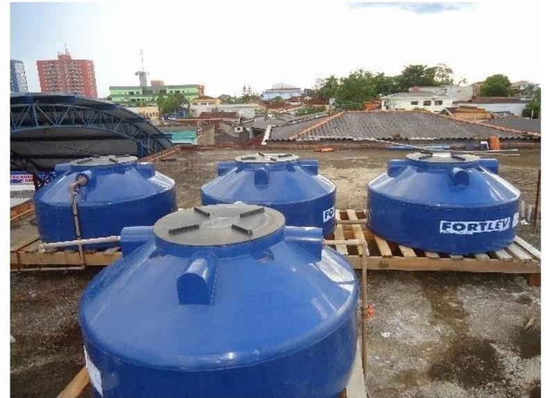
Cisternas de reservação de água
