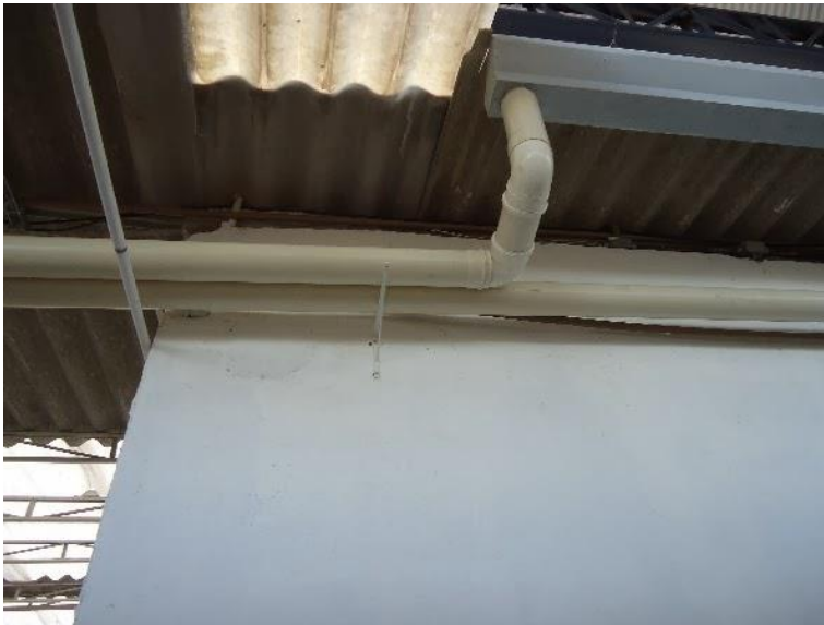
Recolhimento da água da chuva
