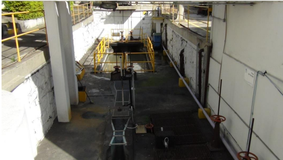
Chegada do esgoto bruto para tratamento
