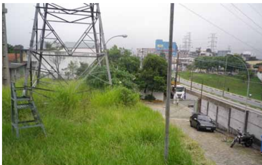
Imagem 2.7: Vista da subestação. Fonte: Idom
