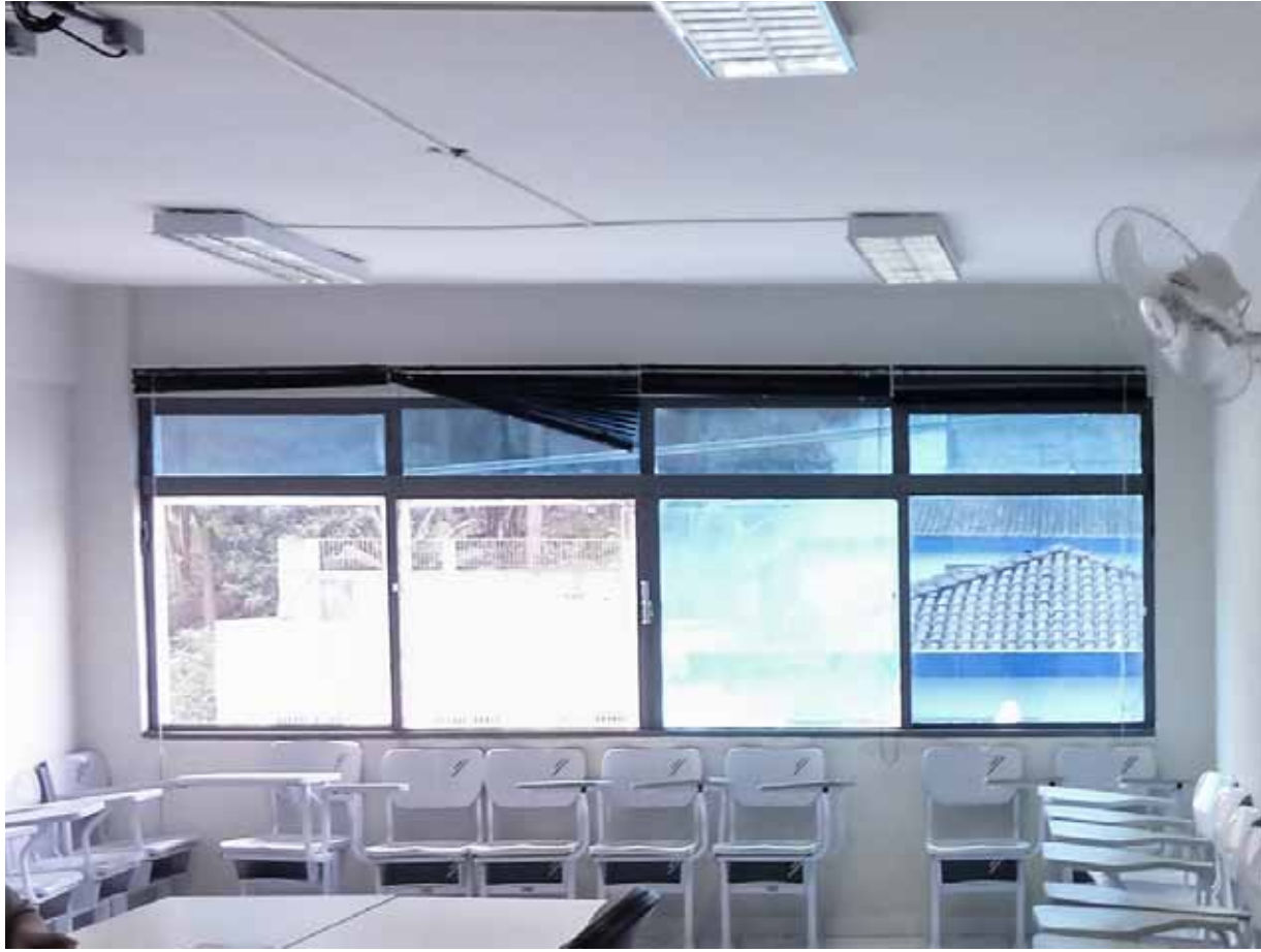
Imagem 5.5.9: Janelas com problemas de manutenção. Fonte: levantamento fotográfico realizado pela consultora.
