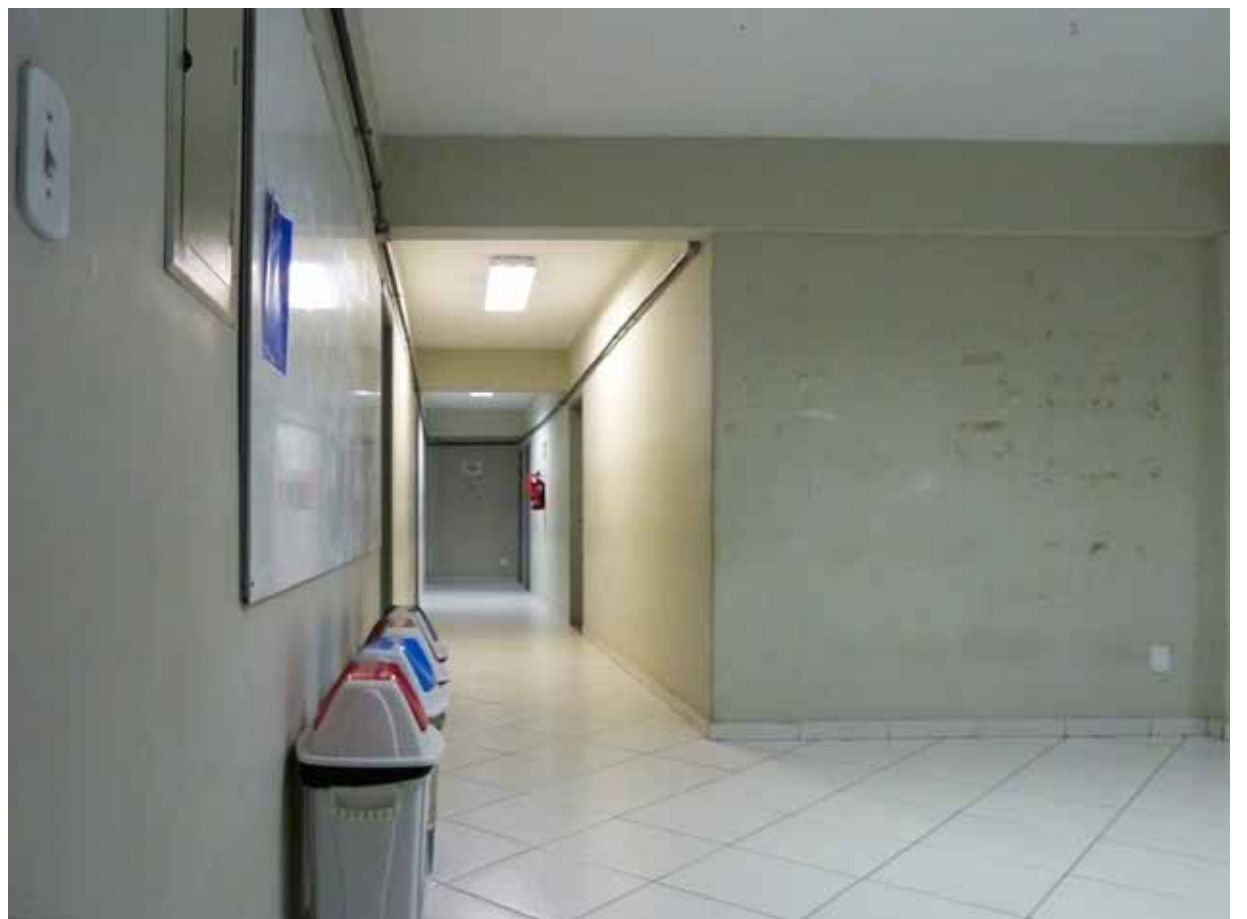
Imagem 5.5.8: Corredor estreito e mal iluminado. Fonte: levantamento fotográfico realizado pela consultora.
