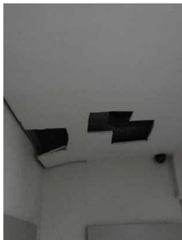
Imagem 5.3.18: Forro em ruínas do pavimento térreo. Fonte: levantamento fotográfico realizado pela consultora.
