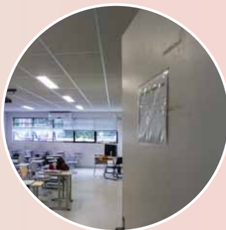
ABERTURA DAS PORTAS NO SENTIDO INADEQUADO
