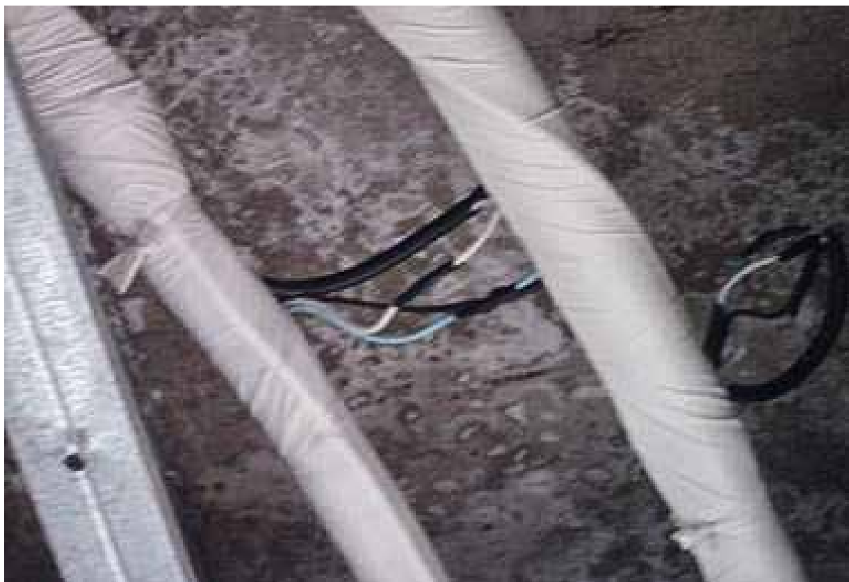
Imagem 5.2.30: Ligação elétrica incorreta. Fonte: levantamento fotográfico realizado pela consultora.
