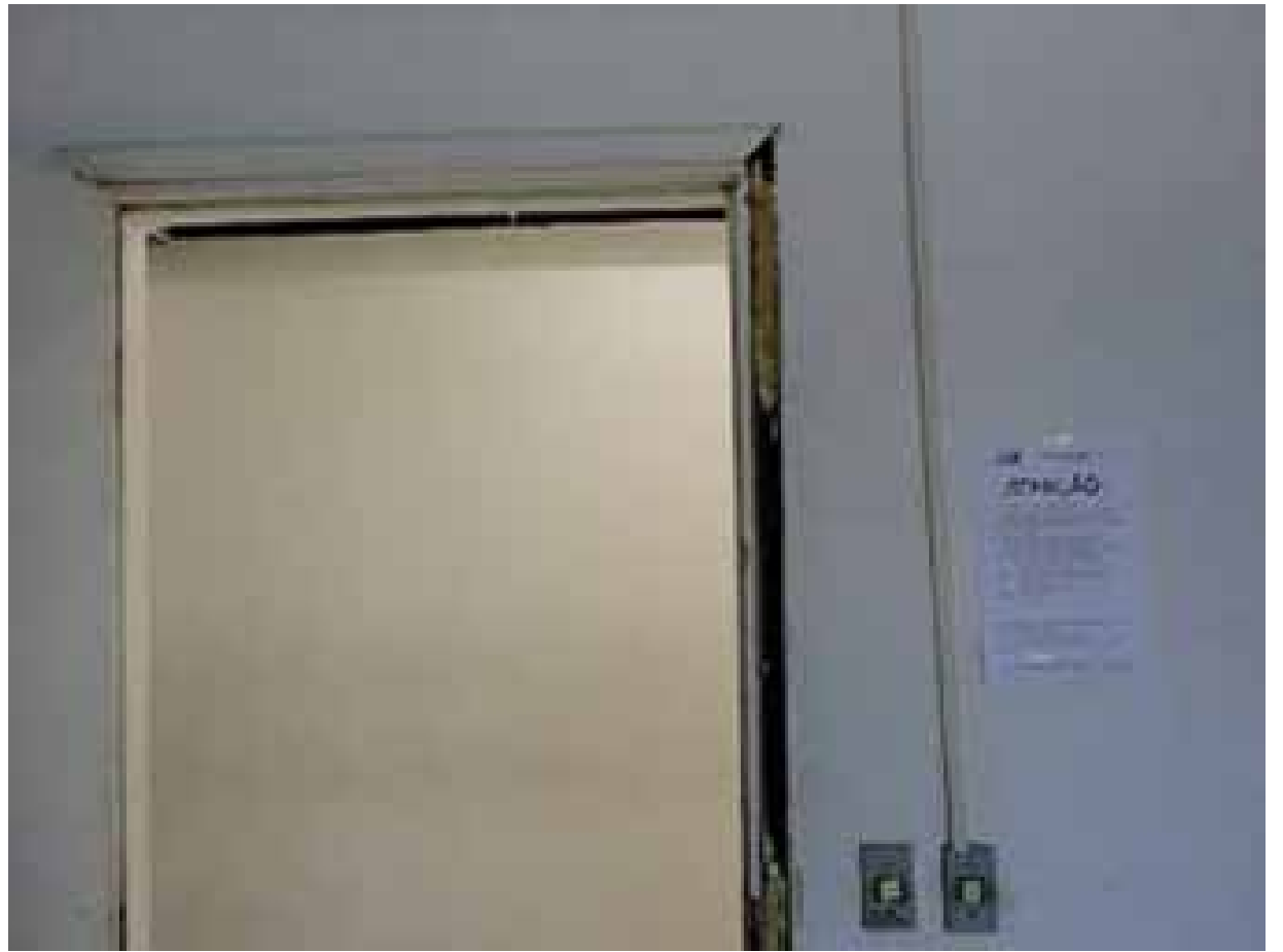
Imagem 5.4.8: Marco de vedação com patologias. Fonte: levantamento fotográfico realizado pela consultora.
