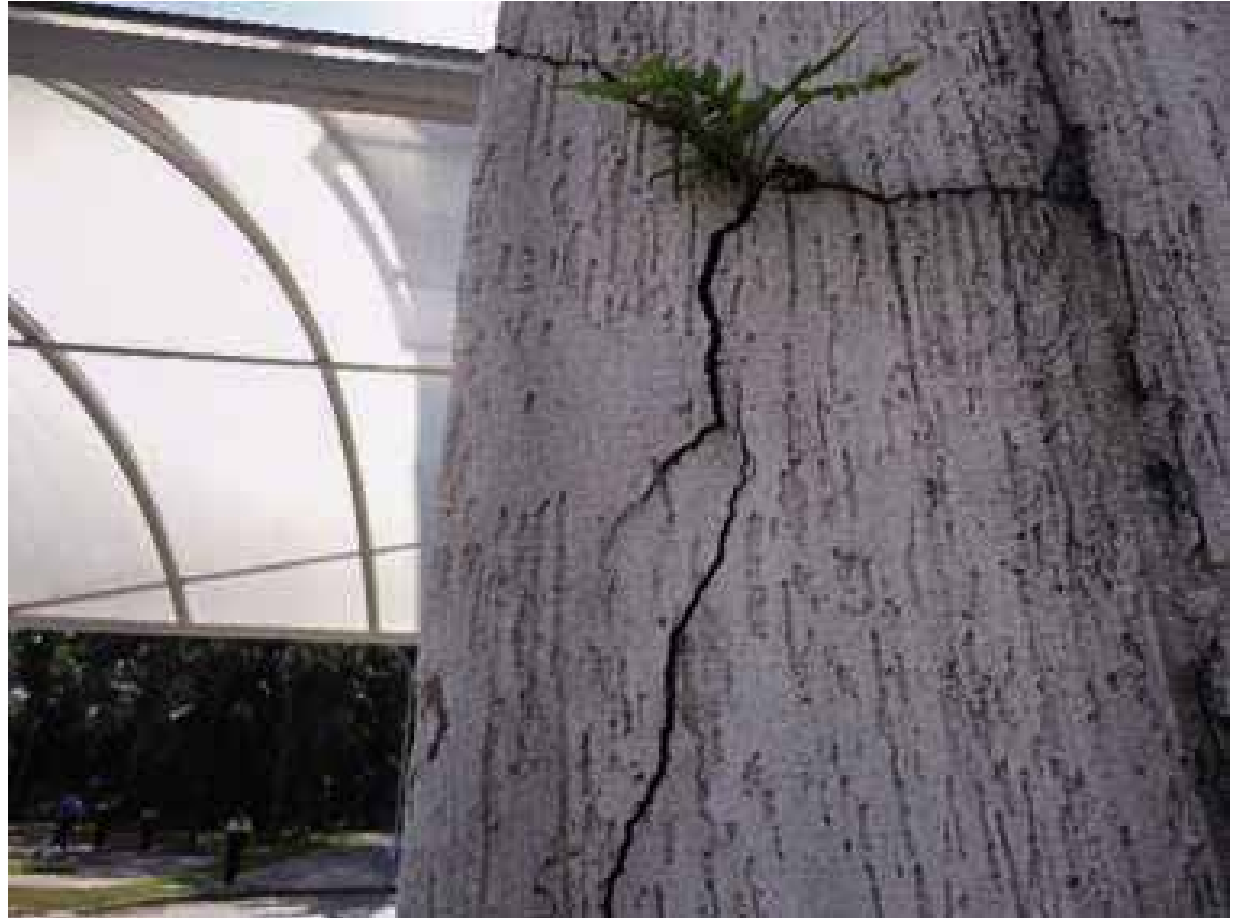
Imagem 5.2.8: Trincas em parede externa. Fonte: levantamento fotográfico realizado pela consultora.
