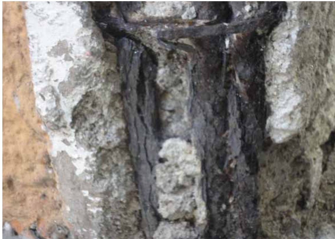
Imagem 5.3.20: Pilares rompidos e armaduras degradadas na planta Térreo. Fonte: levantamento fotográfico realizado pela consultora.
