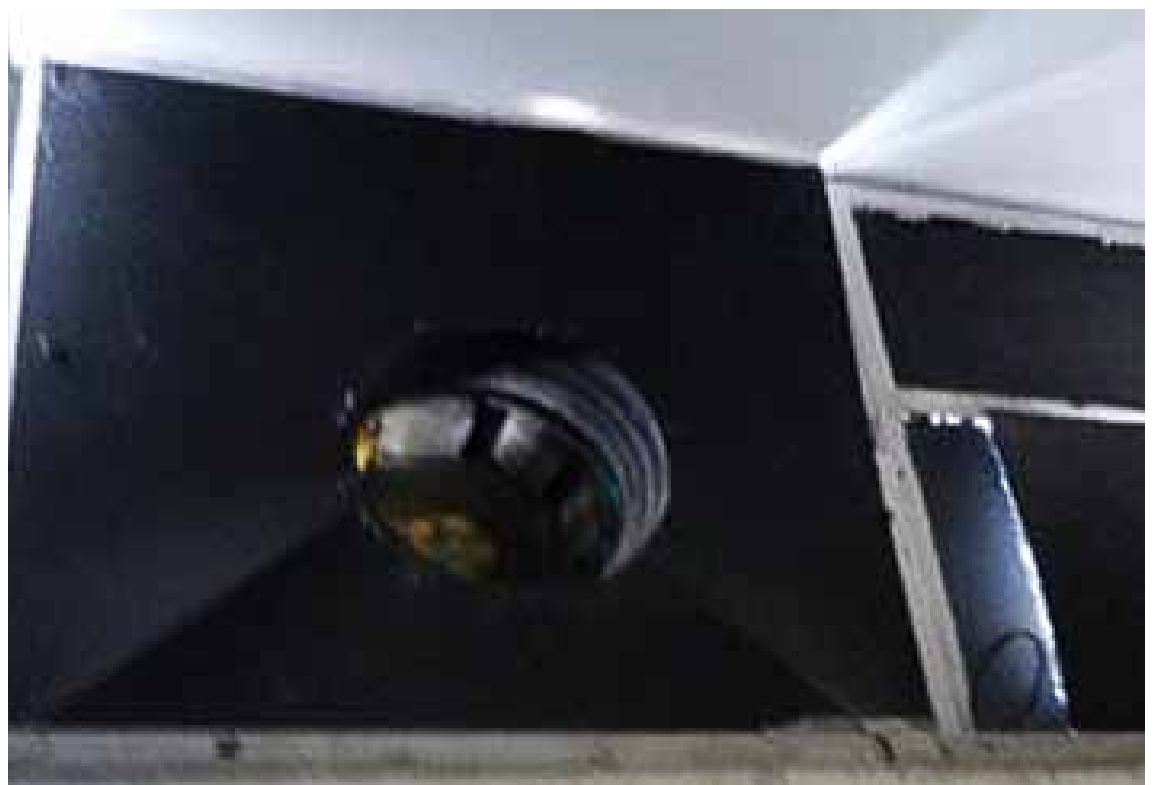
Imagem 5.3.13: Exaustores fora de funcionamento. Fonte: levantamento fotográfico realizado pela consultora.
