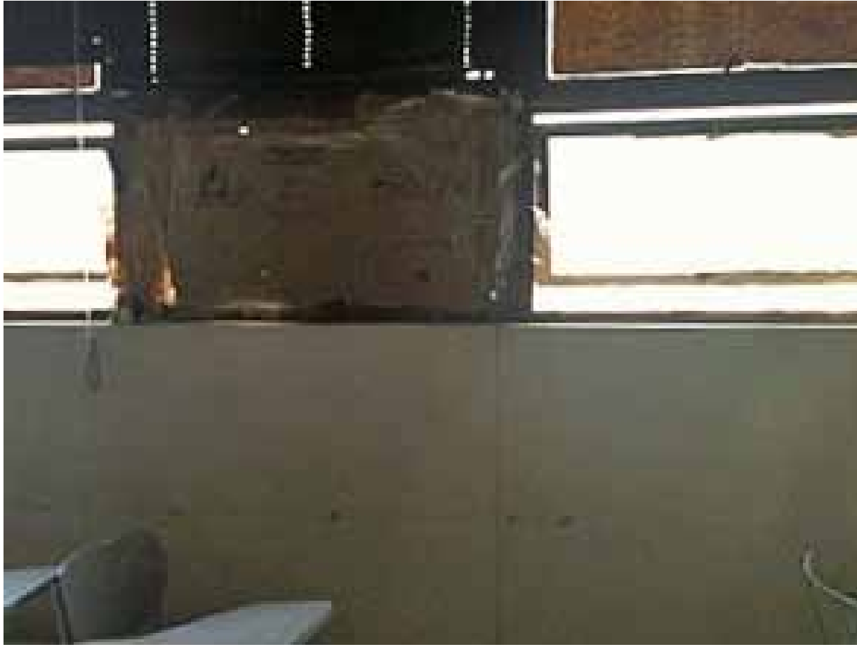
Imagem 5.4.10: Esquadrias deterioradas. Fonte: levantamento fotográfico realizado pela consultora.
