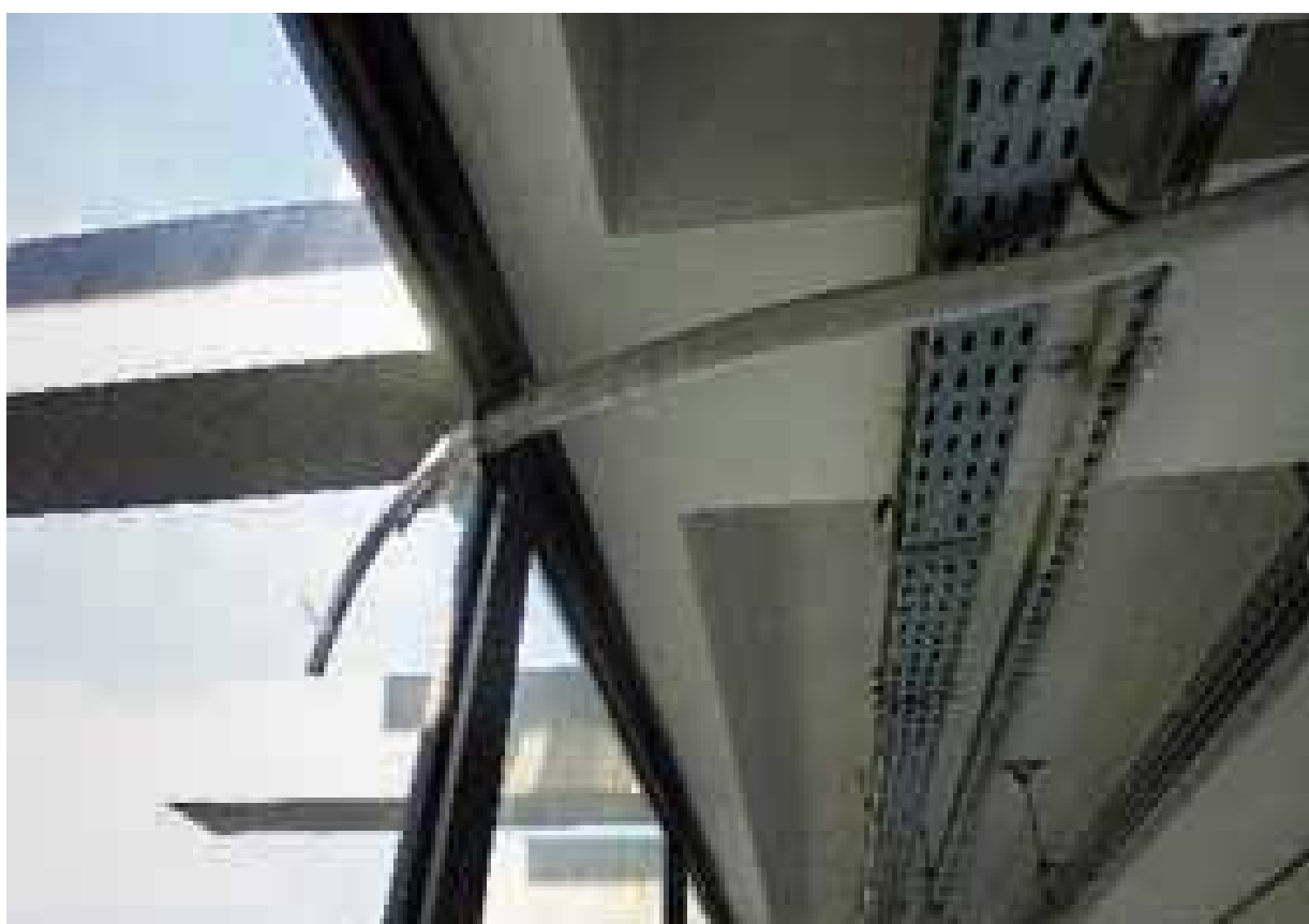
Imagem 5.2.31: Aparelho condicionador instalação incorreta. Fonte: levantamento fotográfico realizado pela consultora.
