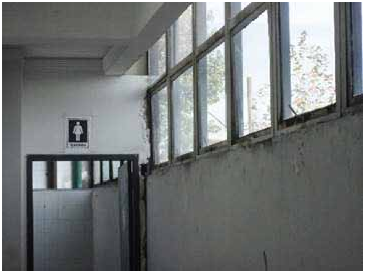
Imagem 5.4.9: Deficiências de manutenção. Fonte: levantamento fotográfico realizado pela consultora.
