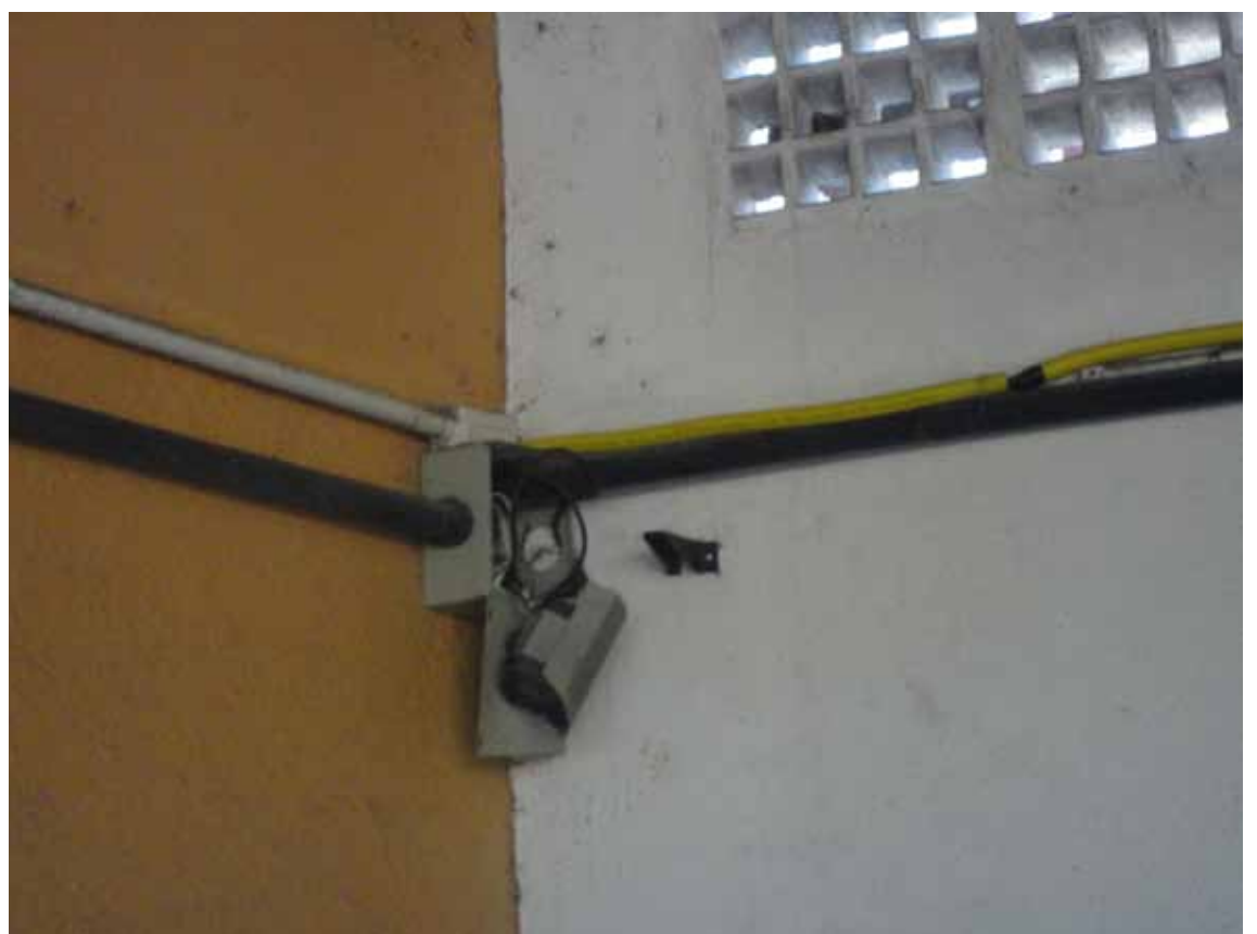
Imagem 5.3.14: Equipamentos de segurança quebrados. Fonte: levantamento fotográfico realizado pela consultora.
