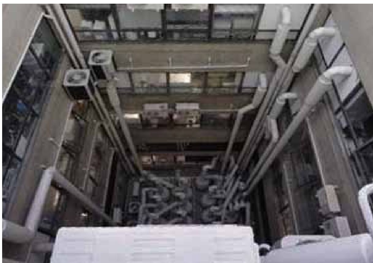
Imagem 5.2.34: Exaustores com ventilação inadequada Fonte: levantamento fotográfico realizado pela consultora.
