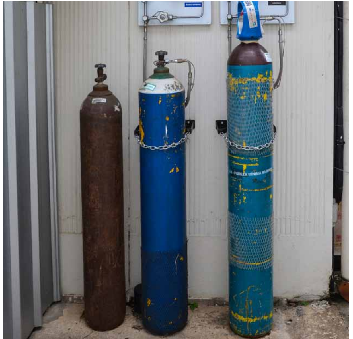
Imagem 5.3.27: Cilindros armazenados incorretamente. Fonte: levantamento fotográfico realizado pela consultora.
