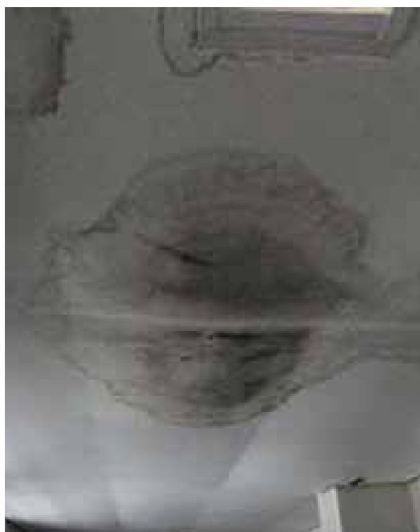
Imagem 5.3.15: Forro em estado de deteriorização avançado. Fonte: levantamento fotográfico realizado pela consultora.
