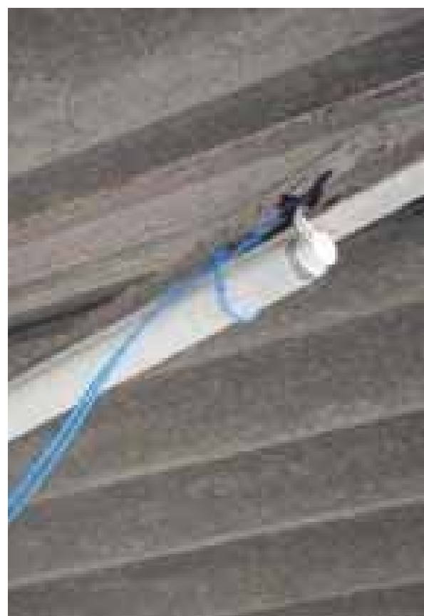
Imagem 5.3.19: Ligação elétrica precária no pavimento térreo. Fonte: levantamento fotográfico realizado pela consultora.
