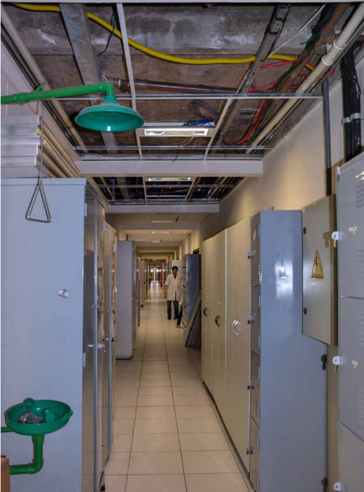
Imagem 5.3.29: Chuveiros fora de funcionamento. Fonte: levantamento fotográfico realizado pela consultora.
