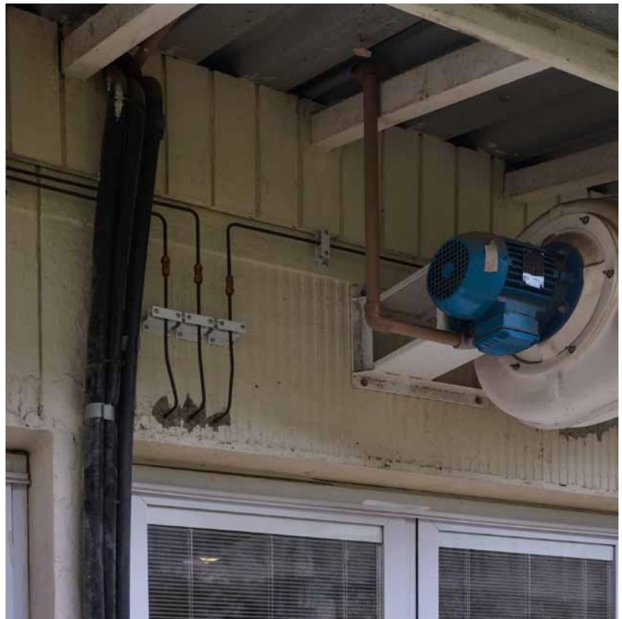
Imagem 5.3.28: Exaustores quebrados. Fonte: levantamento fotográfico realizado pela consultora.
