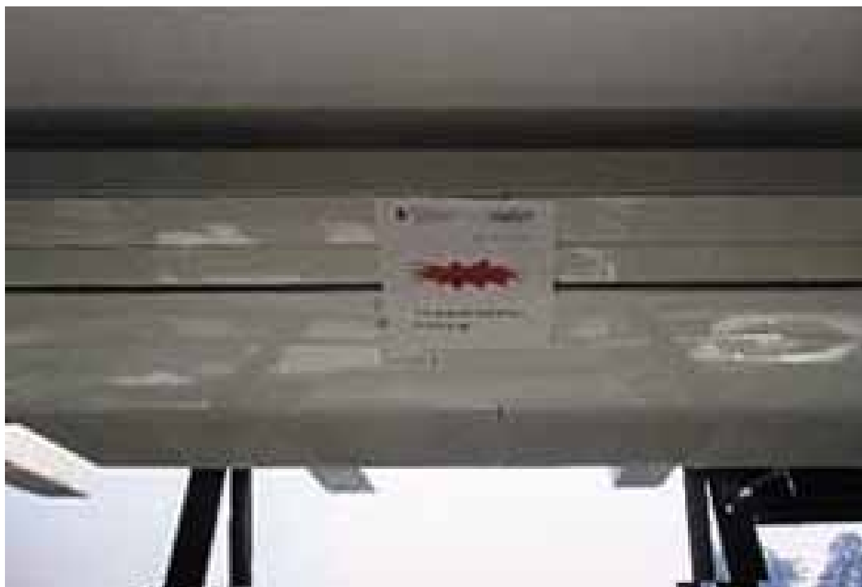
Imagem 5.2.33: Aparelho condicionador fora de utilização. Fonte: levantamento fotográfico realizado pela consultora.
