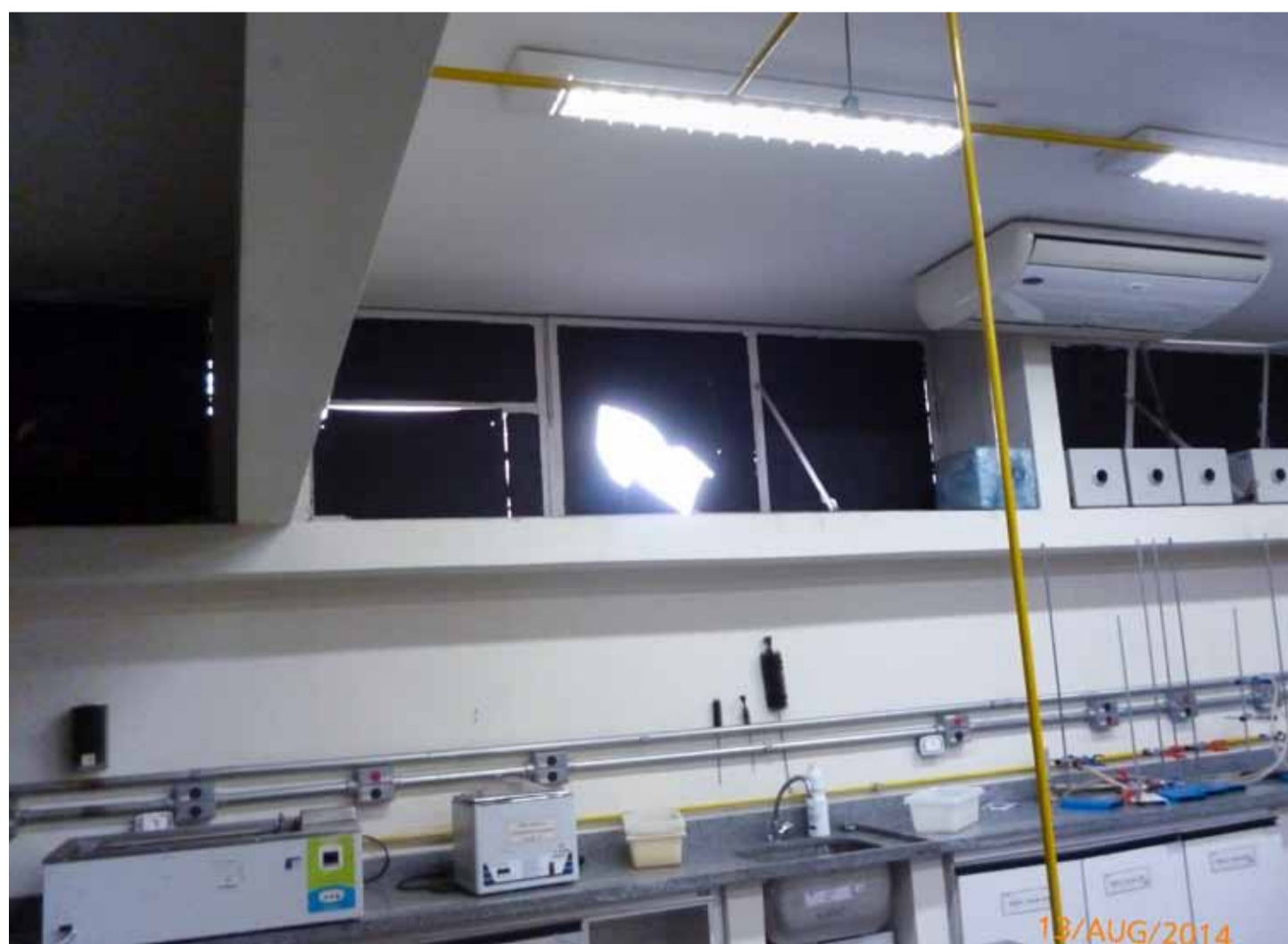
Figura 5.17: Laboratórios com infraestrutura precária Fonte: levantamento fotográfico realizado pela consultora
