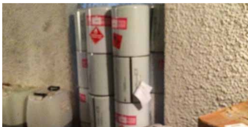
Figura 5.6: Vista interna e armazenamento dos resíduos químicos sobre pallets de madeira
